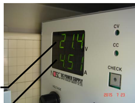
制御盤内 DC電源表示部
